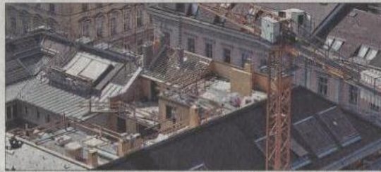
Wenn das Dach fehlt, bedarf es besonderer Sorgfalt.
