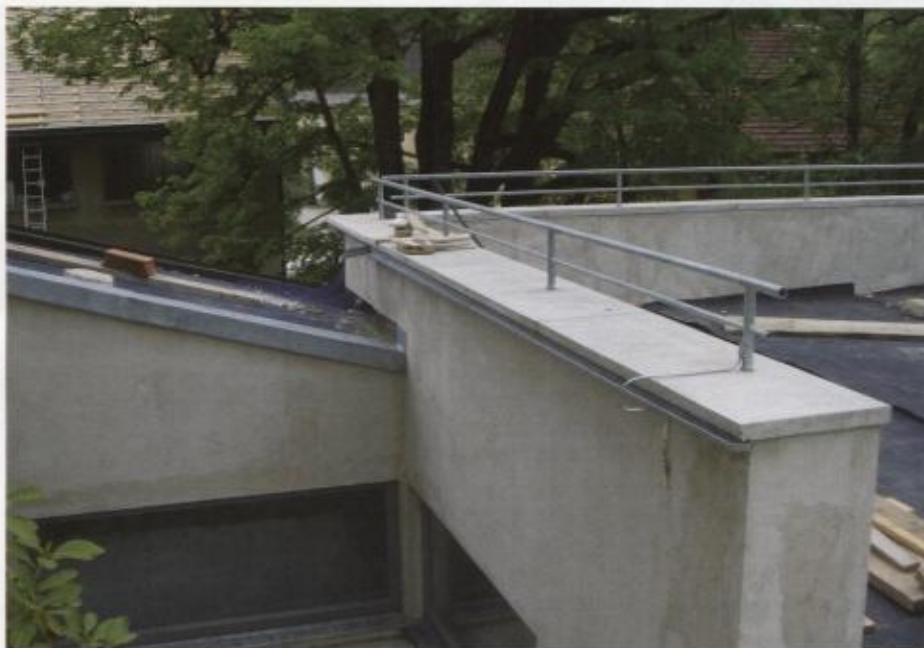
Diese Dachrinne ist einfach zu klein und kann viel zu wenig Wasser aufnehmen.
