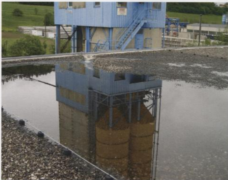
Wenn Wasserlaken auf dem Dach nicht abfließen, können teure Schäden entstehen.
