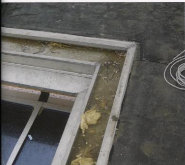
Hier ist klar , warum das Wasser nicht abfließen kann: Der Abfluss ist verstopft.
